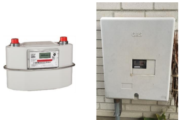
Figur 3: Måler til gas. Billedet af måleren til venstre er udlånt fra Flonidan. Installationen til højre indeholder også trykreguleringen.
