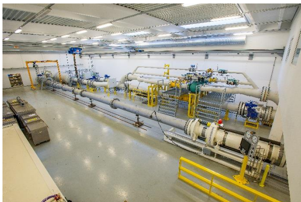
Figur 7 Anlæg til højtrykskalibrering af målere med naturgas imod reference (FORCE Technology, Vejen), rør diameteren på højtryksanlægget er 24 tommer,
